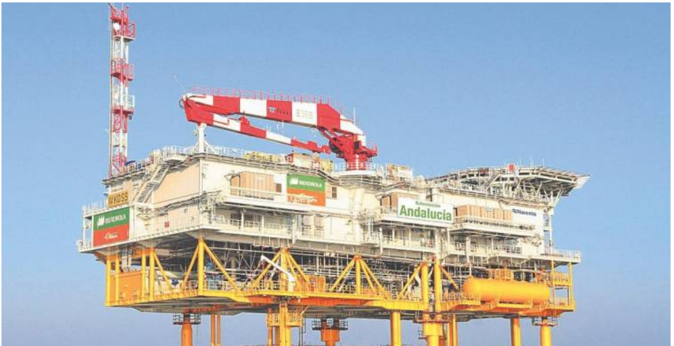
Subestación Andalucía en el parque eólico marino alemán de la compañía
